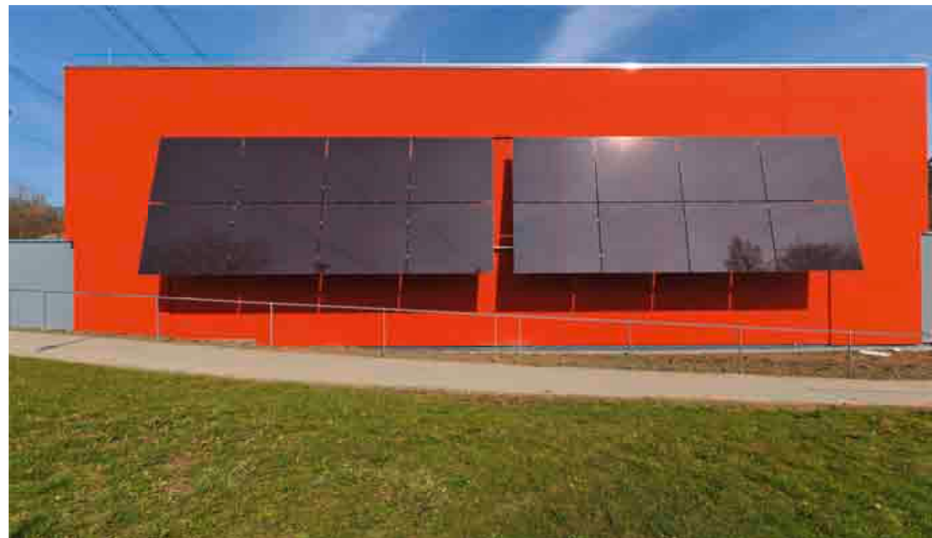
Auch optisch eine gelungene Lösung: Die rote Südfassade und die Dünnschicht-Module von Schüco an der Sporthalle der Weststadt-Schule Ravensburg
